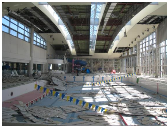
図1 天井落下被害事例
