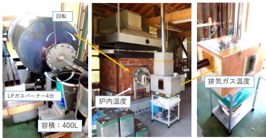
(b) 炉心 (c) 排気ダクト (d) 逆止弁 図4 開発したアルカリ賦活炉 (LP ガス炉)
