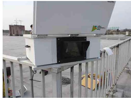
図1 加賀市役所浄化センター屋上に設置された白山雪形観測システム用モニタリングボックス。
