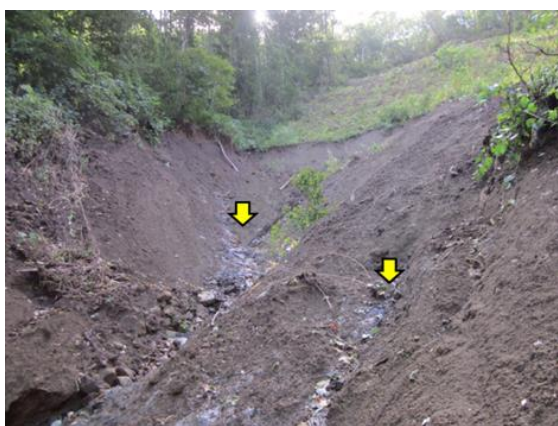
写真1 2015年関東東北豪雨の際の崩壊発生地点。黄色矢印の位置より湧水が認められる。
