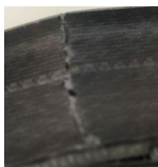
図 4.3.2 引張側破断部分
