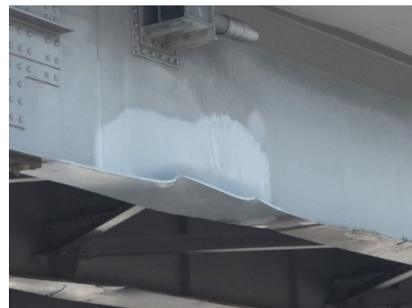
図 - 2 橋梁Bの損傷
