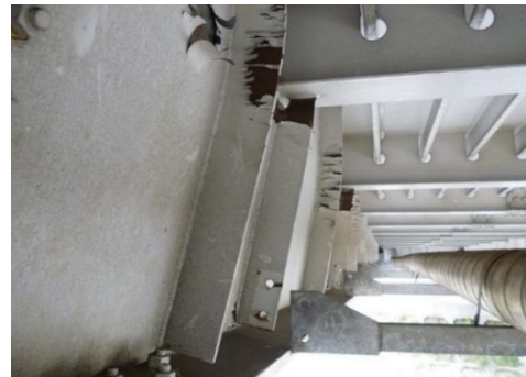
図 - 1 橋梁Aの損傷
