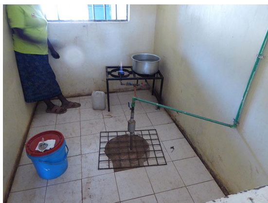
図 7 バイオトイレで発生するメタンガスを利用して、トイレの隣室で料理をつくることできる (2015 年)
