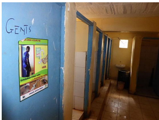
図 6 キベラ内にある公衆トイレ (バイオトイレ) (2015 年)
