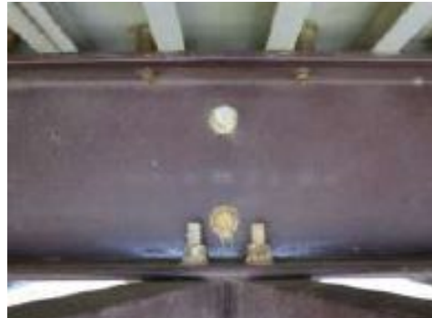
図 - 1 ボルト腐食の例
