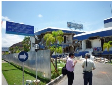
写真1 2009年地震によるRC建物の被害
