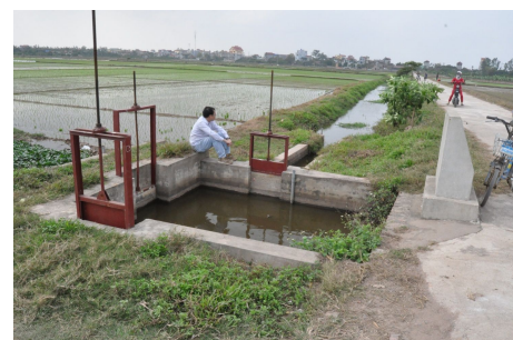
図2 設置した分水工
