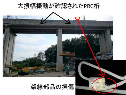
図1：大振幅振動桁（PRC 桁）5 橋のうちの 2 橋の例と架線部品の破断状況
