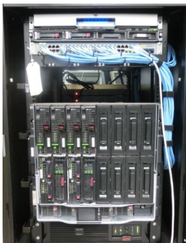
図 1 ラックに設置されたサーバ
