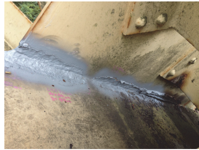
図 6 鋼トラス橋ガセットプレートの腐食損傷
