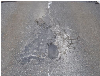
写真-1 舗装上のポットホール
