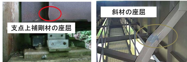
図-1 対傾構、支点上補剛材の地震被害
