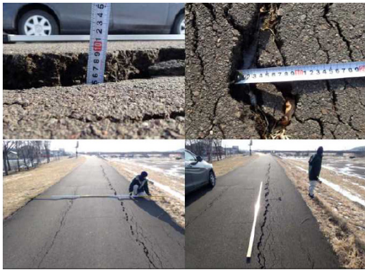
図7 堤防天端舗装のひび割れ
