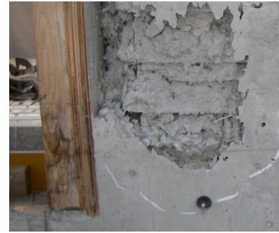
写真1 窓枠付近での空洞の例
