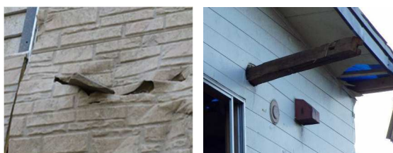
図1 強風時に建物の壁に突き刺さった飛散物 破壊された建物の部材など、“流線型でない形状”をもった物体が衝突することが多い
