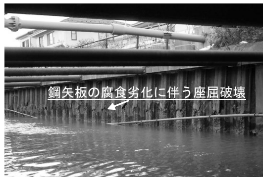
図-1 住宅混住地域における鋼矢板水路の腐食実態と座屈破壊事例(新潟県亀田郷地区)
