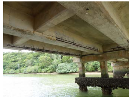
図-1 塩害劣化した構造物の例
