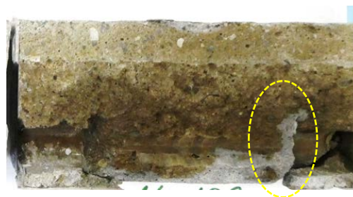
図-7 収縮ひび割れから塩水が浸透した例
