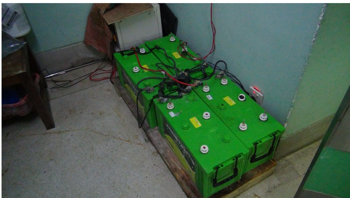
図2 無停電電源装置
