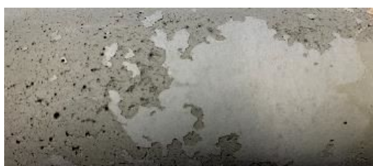
写真-1 硬化後に表面のセメントペーストを剥がすと直下に隠れ気泡の存在を確認
