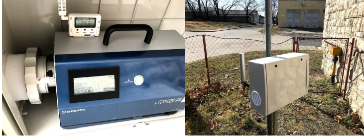
図 5 エアサンプラーの設置状況
