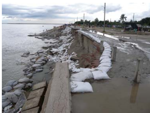
図 1 護岸の決壊事例（ジョムナ川のシラジガンジハードポイント、2009 年 7 月）
