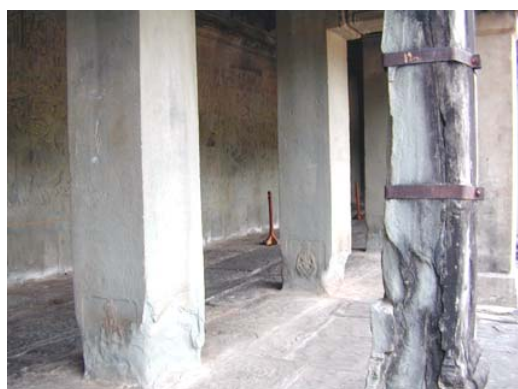
図1 第1回廊の砂岩柱の劣化状態(2005年3月) 右手は強度に劣化した砂岩柱、左手は基部にノッチ状のへこみを伴う砂岩柱。
