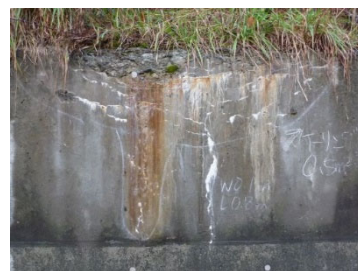
図1 開水路側壁における凍害の変状
