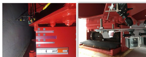
図-6 支承の変状(変位)検出
