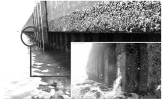
腐食等により発生した鋼矢板護岸の穴開き事例(干潮時撮影)
