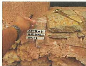
写真 3 試料 3 (A 棟下段北面外部窓廻り化粧モルタル)
