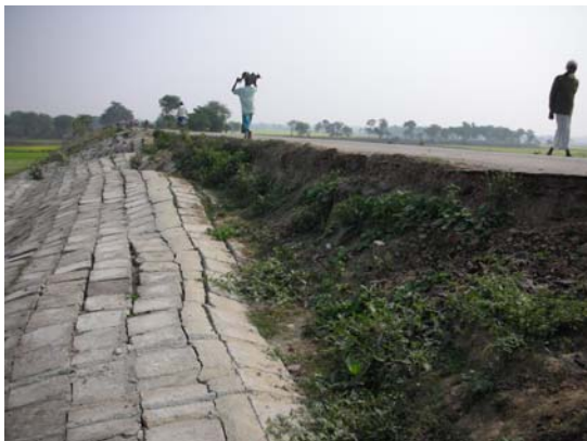
図2。ゴダガリ地区の盛土堤防の崩壊
