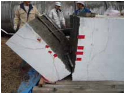
写真7 無筋コンクリート躯体の破断面
