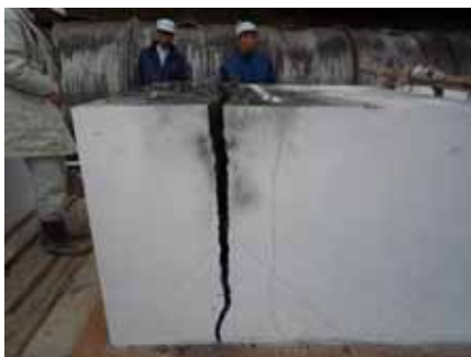
写真8 鉄筋コンクリート躯体の破断面
