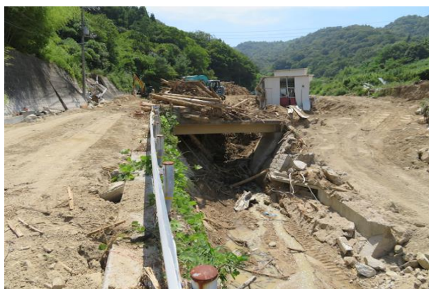
図-1 橋梁が流木と土砂によって閉塞し、氾濫が生じた場所(2018年7月の西日本豪雨、広島県坂町総頭川にて撮影)
