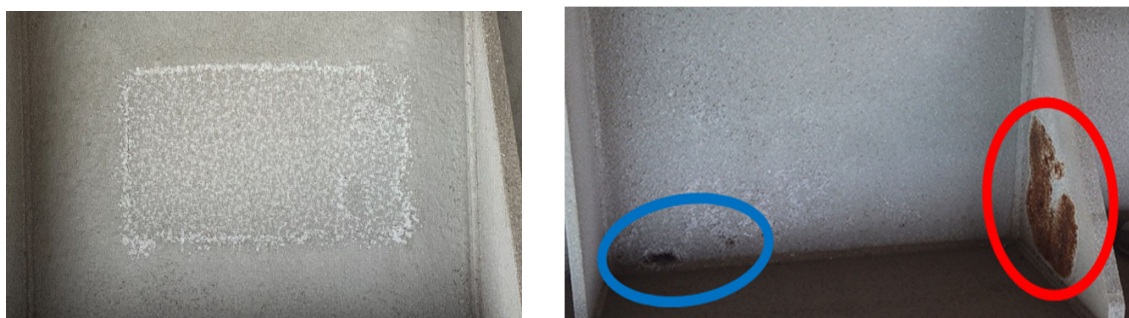
(a) 白さび (b) 局所的な腐食(青)と広がりを持った腐食(赤)
