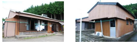
写真7、8 トタン製の雨除け板
