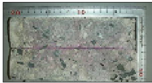
写真2 ひび割れ面の中性化の様子
