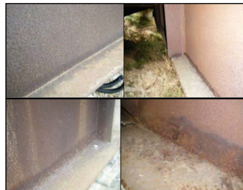
写真 4 橋梁 A のさびの状態 (左上: G1 桁外側、右上: G1 桁内側 左下: G4 桁外側、右下: G4 桁内側)
