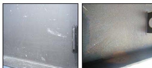
写真 5 橋梁 B のさびの状態 (左: G1 桁外側、右: G1 桁内側)
