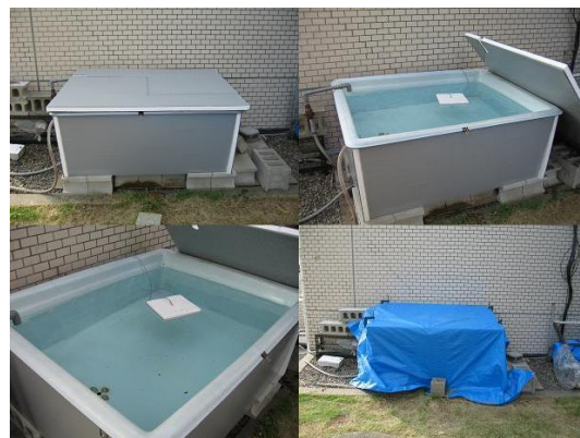
図8 貯湯槽の外観
