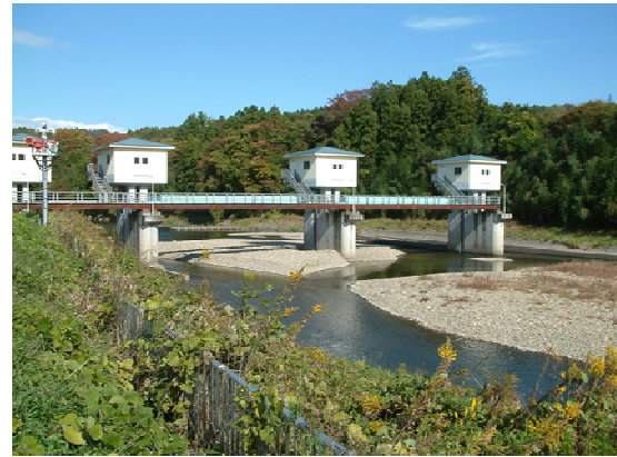
図-7 森田頭首工ゲート周辺の堆砂状況
