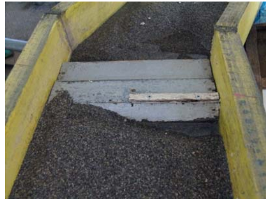
図-5 複合堰の固定堰上流河床洗掘
