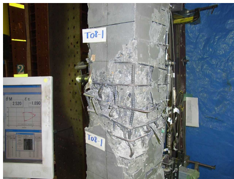
図 5 実験終了後の損傷状況 (T08-1 試験体)
