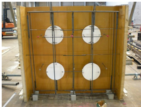
(b) 発泡スチロール板による内部水平ひび割れを模擬した床版の型枠組立状況
