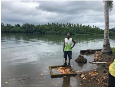
写真1 海岸浸食と住宅の基礎
