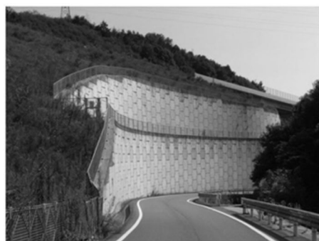
図1 補強土壁(帯鋼補強土壁：テールメ) (テールメ協会ホームページより参照)
