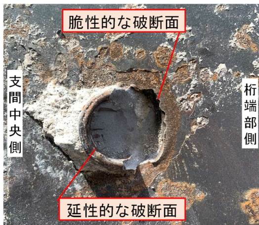
写真-2 スタッド破断面
