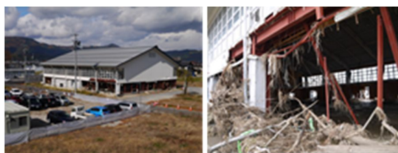
(a) 外観 (b) 南東の外壁面被災 図4 対象建物
