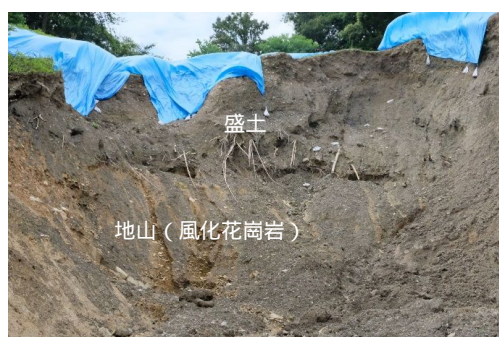
写真 2 盛土崩壊の滑落崖。盛土底面にソイルパイプが連続し、空洞化している。
