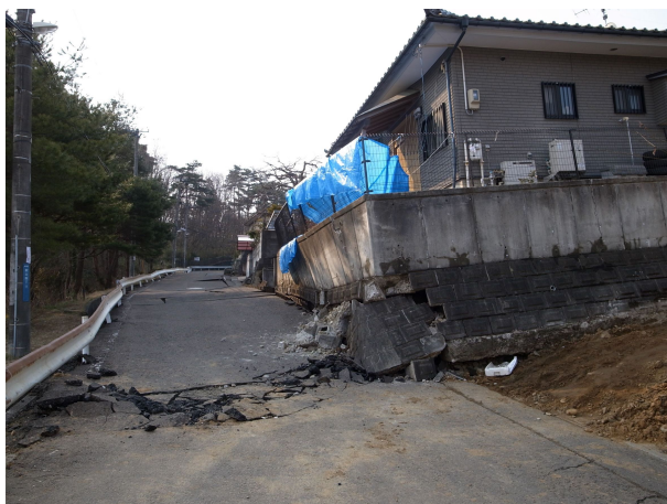
写真1 2011年東北地方太平洋沖地震による谷埋め盛土末端の宅地崩壊（仙台市青葉区）
