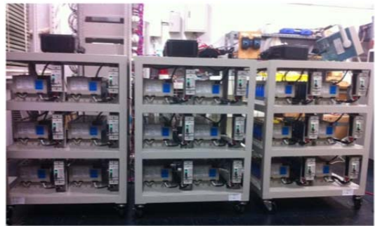
図 2 実験に使用した 18 台 (=6×3 台) のリチウムイオン電池モジュール
