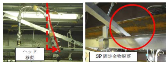
写真2 スプリンクラーヘッド部のずれ
