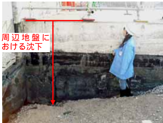
写真-1 地震による地盤沈下の事例
