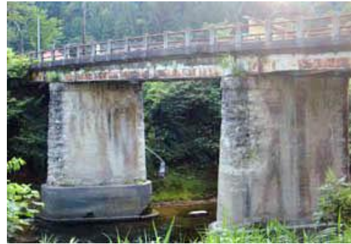
図-5 調査対象の凍害橋梁
