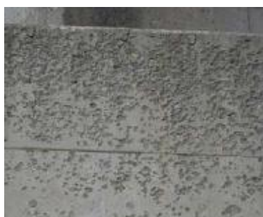
図-1 融雪剤による橋台のスケーリング 1)
