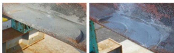
b) 損傷部(外側) c) 損傷部(内側)
